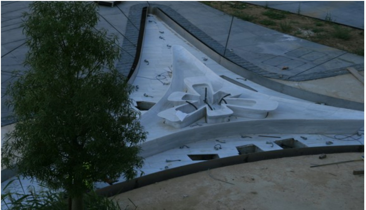
Рис. 21. Строительство парка Элефтерия у бастиона венецианской крепости в Никосии (арх. Заха Хадид, фото И.В. Кукиной)
