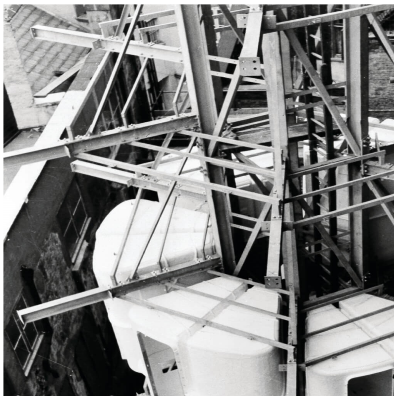
Рис. 2. Установка металлических кабин ваннных комнат в каркас башни с пандусом. Арх. бюро “Farrell & Grimshaw”.
